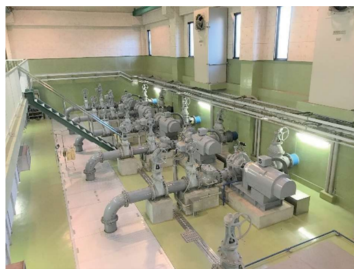
北部浄水場 配水ポンプ
