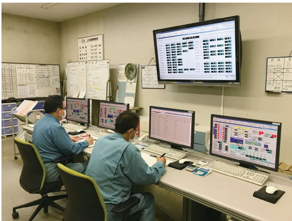
浄水場監視制御システム
