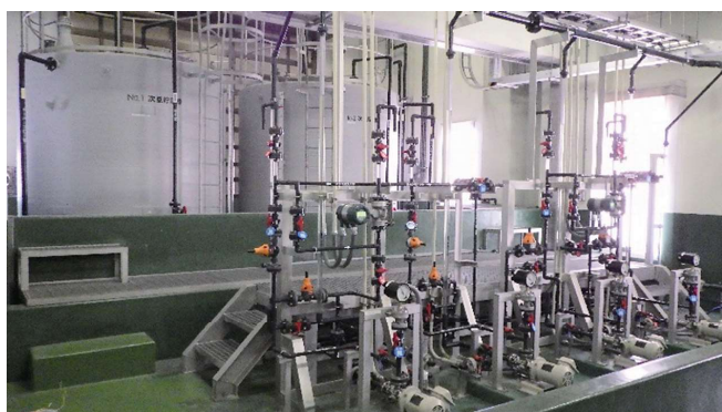
東部浄水場 次亜塩素酸ナトリウム注入機
