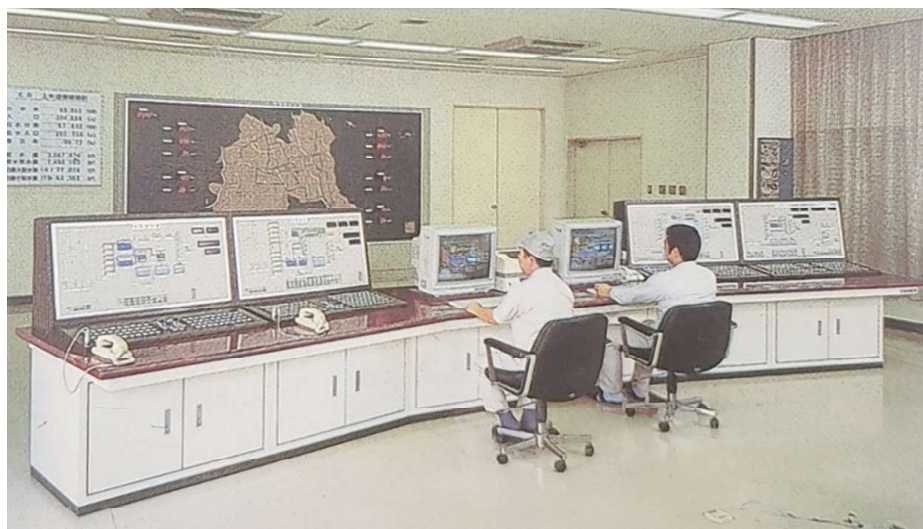
集中監視室(中央浄水場)
