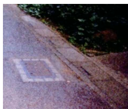
老朽化して蓋のがたついた弁室
