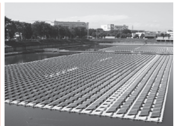
水上式メガソーラーシステム (桶川市赤堀地内)
